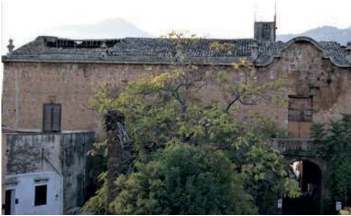
La settecentesca villa Arena Mortillaro a Cruillas; si noti il crollo delle coperture
