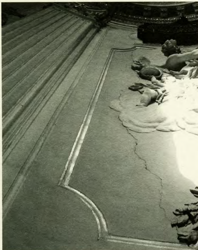
Chiesa di Santa Maria della Pietà, lesione verticale sulla parete dell'abside
