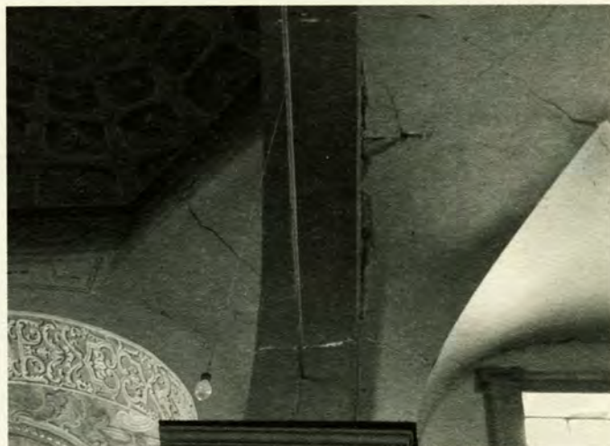
Chiesa di Sant'Anna, lesioni sul soffitto con distacco dell'arco. Le foto sono dell'autore
