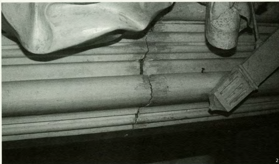
2. Lesione provocata dal terremoto del 2002 in cui si intravede una riparazione legata ad una precedente apertura della lesione.
