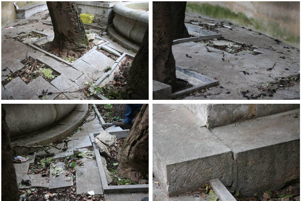
Fontana dei Draghi. Particolare della pavimentazione dell'emiciclo. L'apparato radicale delle essenze arboree piantumate senza un preciso disegno e in prossimità della fontana ha sollevato quasi tutta la pavimentazione e compromette anche la stabilità dello scalino aggiunto.
